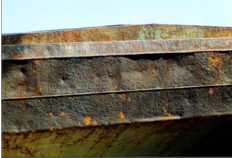
الشكل (3) التآكل الثقيل لسطح الفتحة وسطح الخزان العلوي
